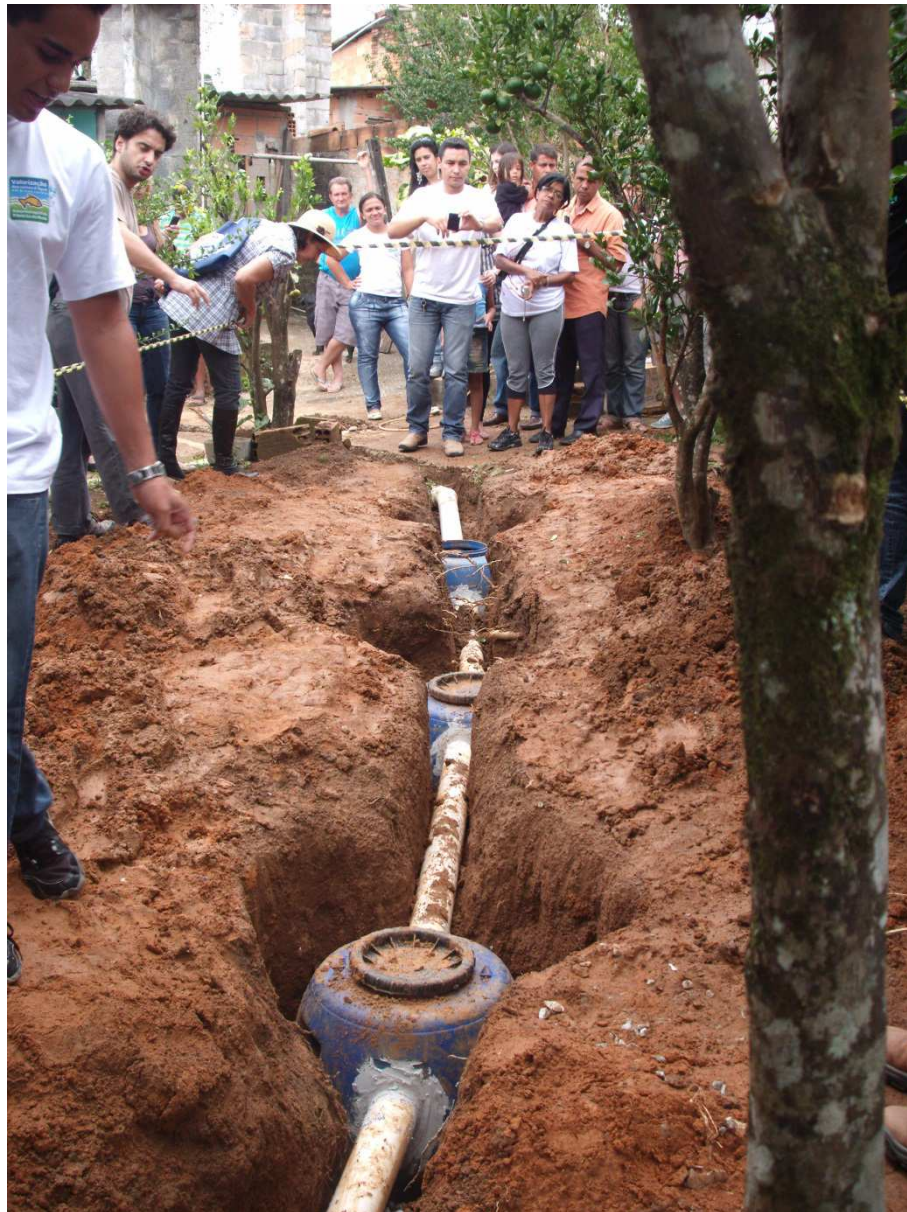
Foto 3: Fossa séptica econômica instalada na sub bacia do Ribeirão da Mata Fonte: GERHI (2012)
