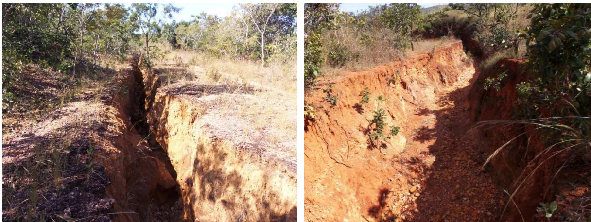
Fotos 12: Erosão a recuperar no Assentamento Resistência Fonte: GERHI (2013)
